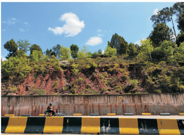
c 边坡侵蚀
