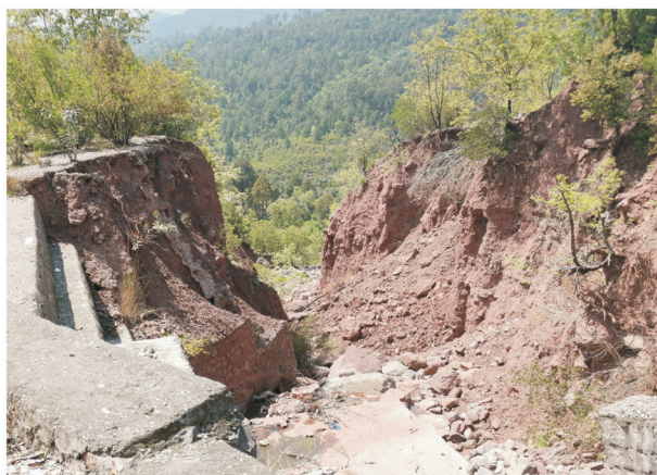
d 沟道边坡侵蚀(陈同德摄于20190418)
