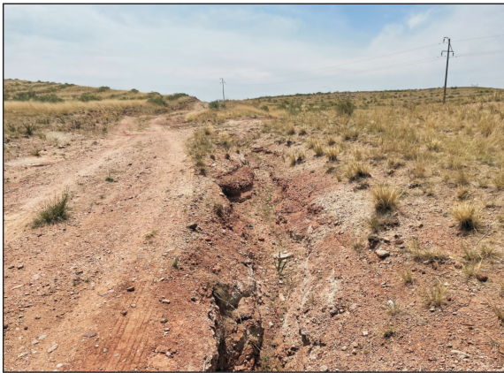
图 12 道路侵蚀(张怡捷摄于 20230624)
