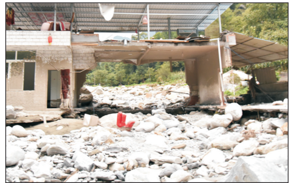
图 3 泥石流对墙体冲击破坏
