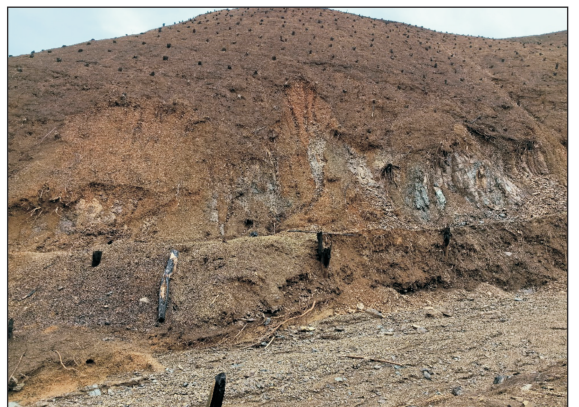
b 公路内侧坡面溜坍
