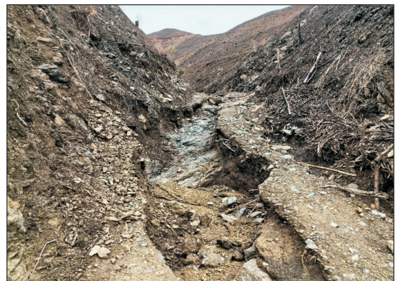
d 支沟沟道下切侵蚀
